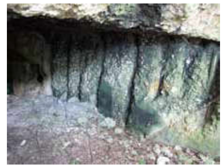
てつきん ぬ へき 鉄筋を抜かれたコンクリート壁
